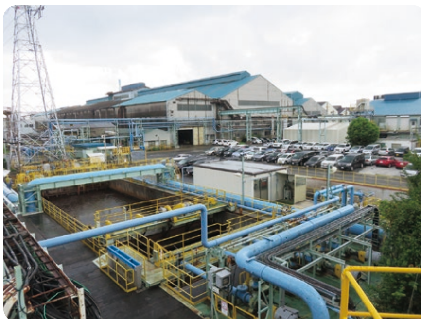
星崎工場排水処理
